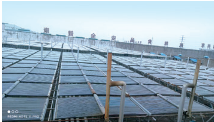
Solar Collectors 太陽能集熱設備
